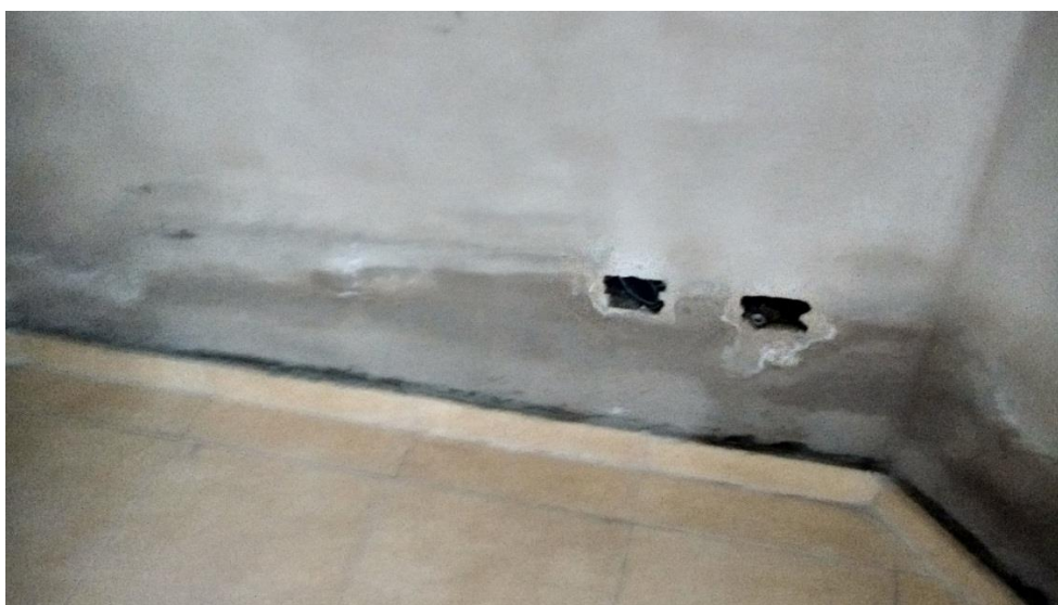
Imágenes: Dormitorio, se observa puerta, placard, piso y ventana colocadas. Falta pintura y accesorios de luz. Áreas con presencia de humedad.
