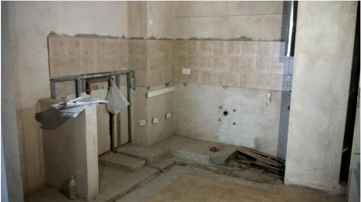
Imagen: zona de Cocina, revestimiento de cerámicos en muros y piso, falta todos los artefactos y mesada. Conexiones de agua y gas embutidas por muro y piso.
